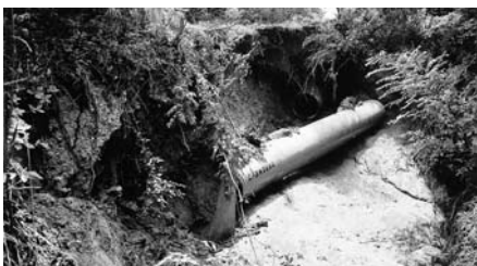
パイプライン管 800mm 破損による山林崩壊状況
